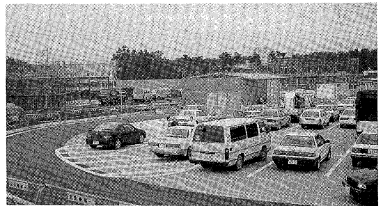
写真-6 駐車場における半たわみ性舗装 (関越自動車道 三芳PA改築工事)
